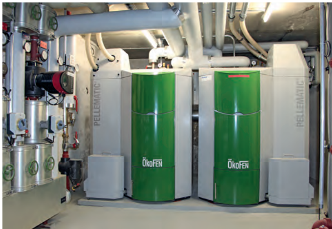
Neue Pellet-Heizung im SH Berg
